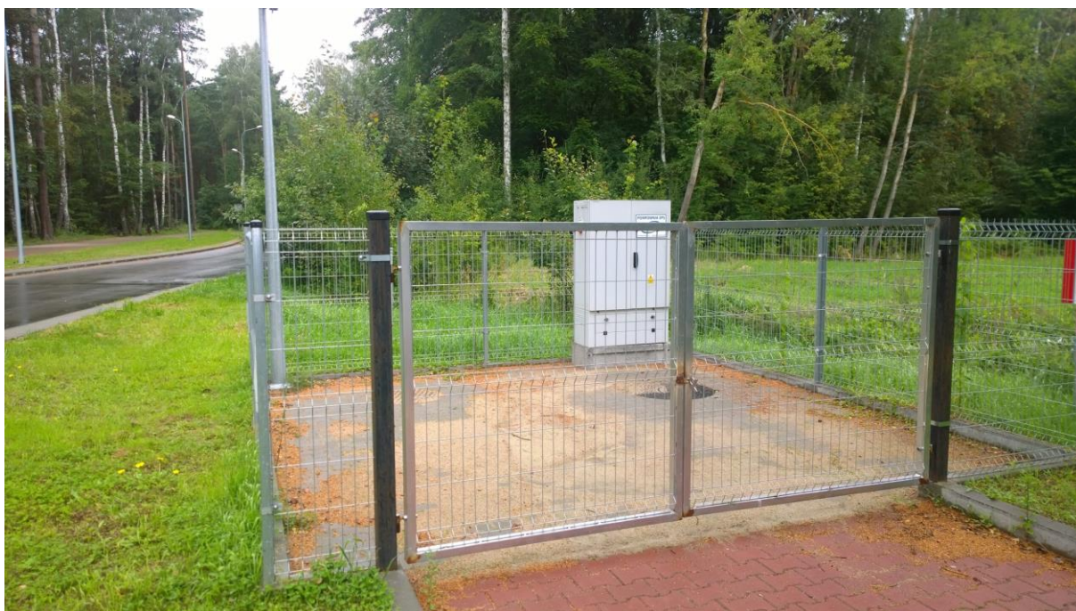
Przepompownia ścieków Sztutowo ul. Obozowa
