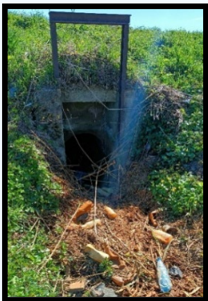
Fot. 1. Nagromadzenie śmieci powyżej przepustu z piętrzeniem, autor: W. Warowna
