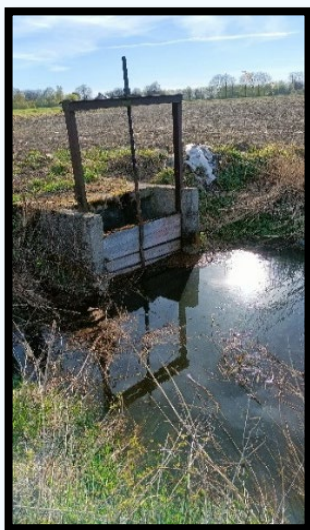
Fot. 6. Działająca zastawka melioracyjna z drewnianą zasuwą, autor: W. Warowna
