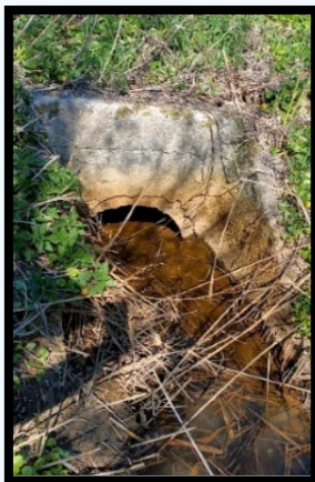
Fot. 2. Zamulony przepust pod drogą na rowie melioracyjnym, autor: W. Warowna
