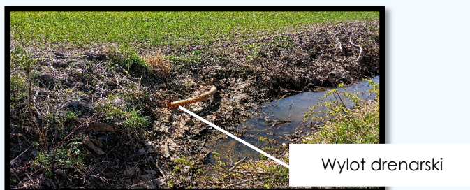
Fot. 9. Odkryty wylot drenarski w stanie uniemożliwiającym swobodny odpływ wody, autor: W. Warowna
