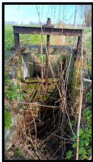
Fot. 7. Zastawka melioracyjna wymagająca remontu zamknięć i elementów betonowych, autor: W. Warowna
